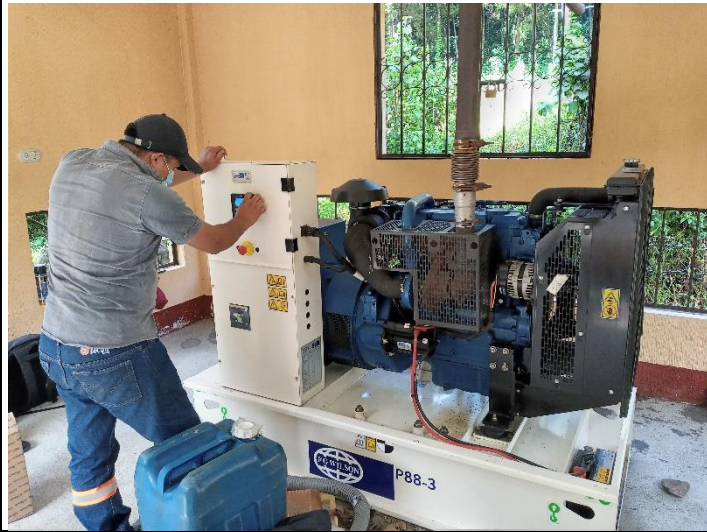
Mantenimiento constante del generador de la bomba de agua
