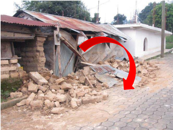
Imagen 5 : Vivienda afectada por derrumbe de muro de Adobe, mal adobe y falta de reforzamiento o amarre
