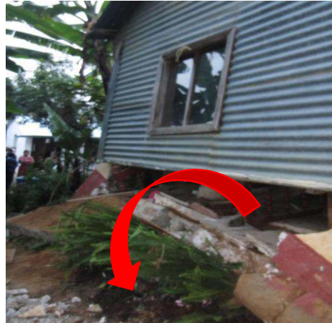
Imagen 6: Caída de parte de muro pequeño en vivienda por falta de columnas y amarre.
